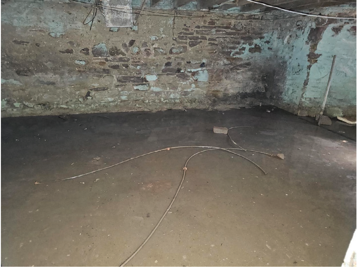
Flooding in basement (ERA, 2023).
