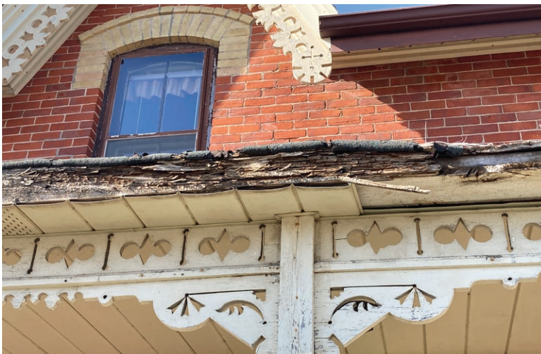
Rotted porch fascia (ERA, 2023).
